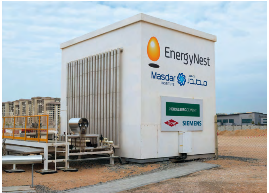
↑ Abb. 9b: Fertiggestellter EnergyNest-Speicher
